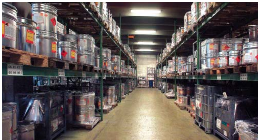
Leitfähiger Fußboden zur Vermeidung elektrostatischer Aufladung, Lüftungs- und Beleuchtungstechnik in ex-geschützter Ausführung, automatische Brandmelde- und CO 2 -Löschanlage: Blick ins VS Logistik-Gefahrgutlager für brennbare Flüssigkeiten (VbF AI-AIII und B).
